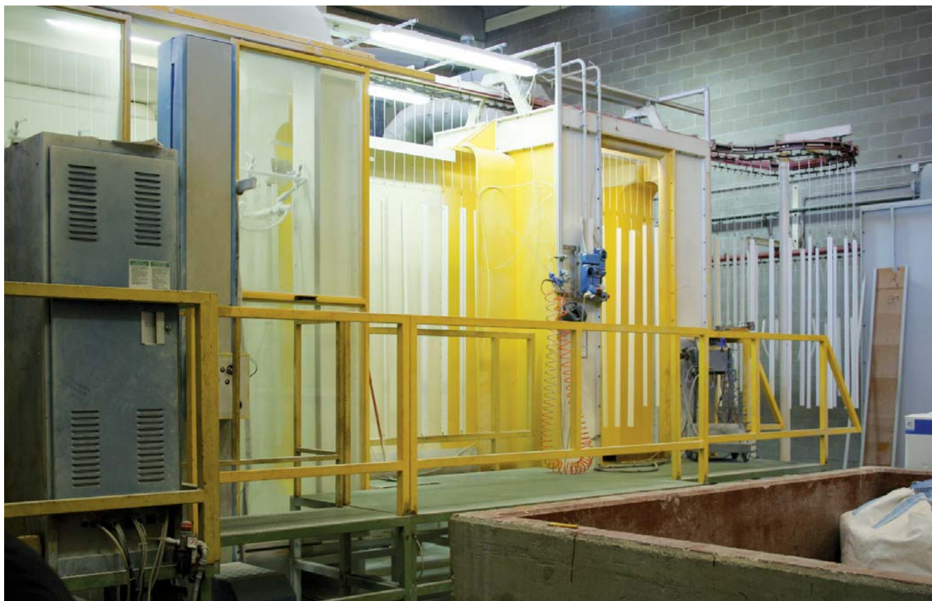
4 - La cabina automatica di erogazione polveri. La cabine automatique de distribution des poudres.
