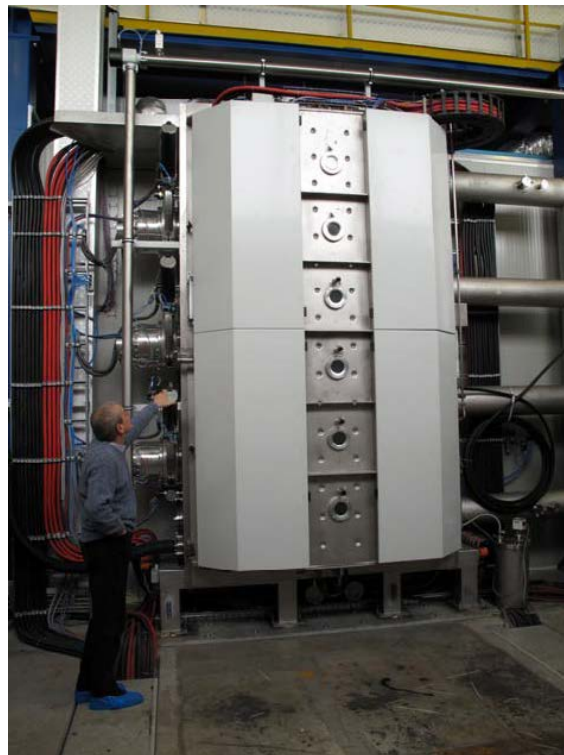
Fig 4. Camera grigia. Il portellone per manutenzione, gli schermi di protezione racchiudono i catodi.
