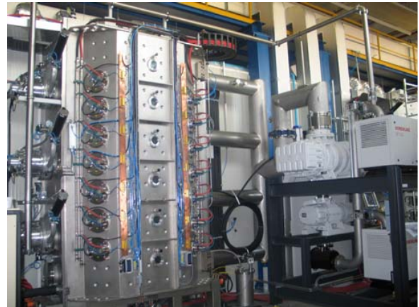
Fig 2. Camera grigia. Si notano il gruppo di pompaggio e i catodi posti sulla parete della camera prima che vengano montati gli schermi di protezione
